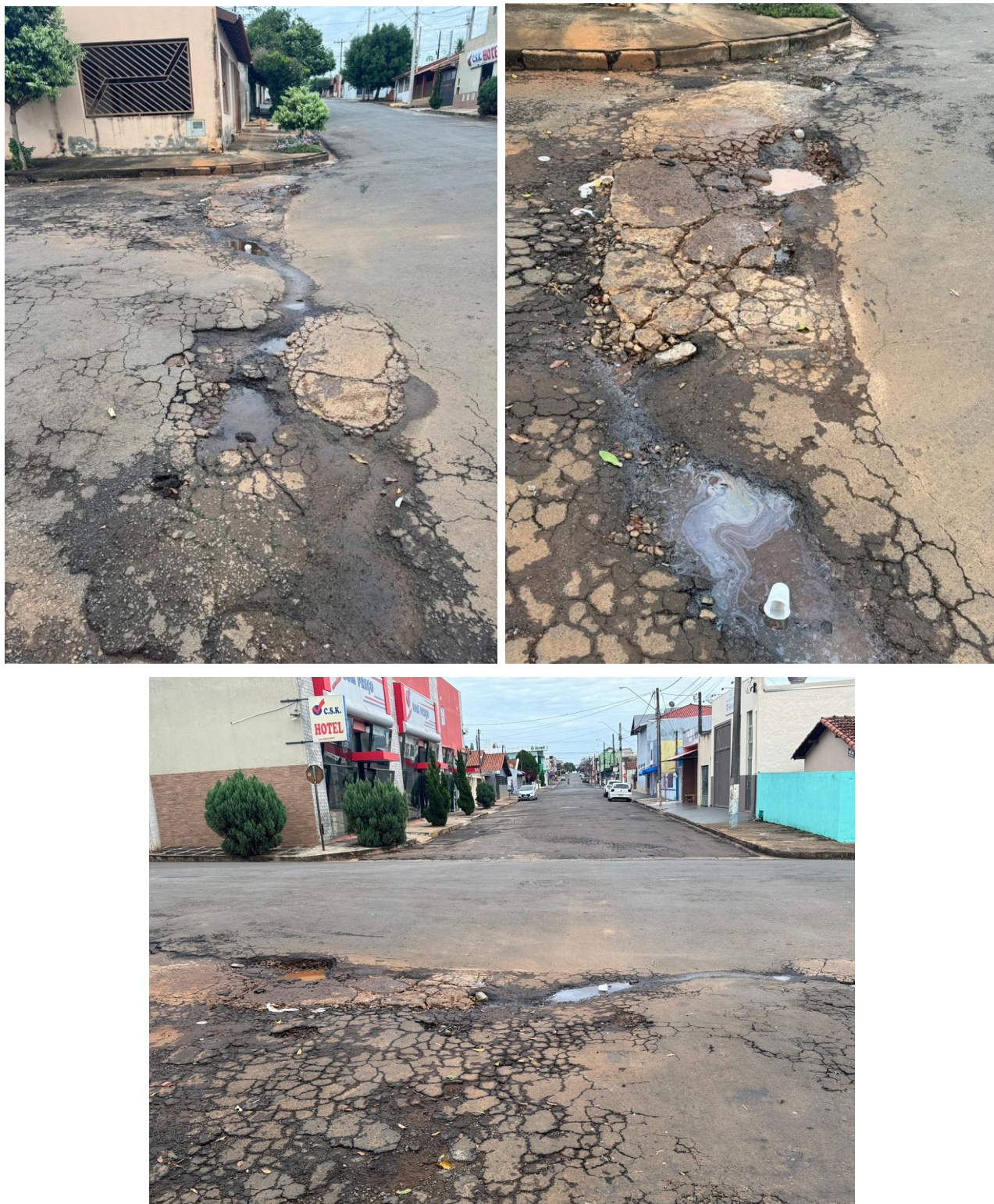
Imagem 1 – fotografias que registram o estado da via
